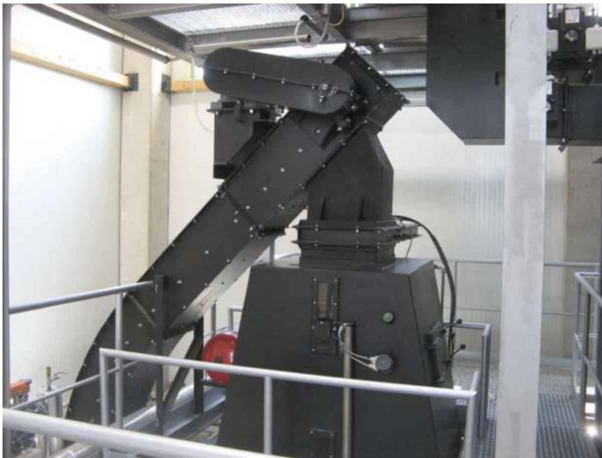
Слика бр. 19: Дозирни систем котла
