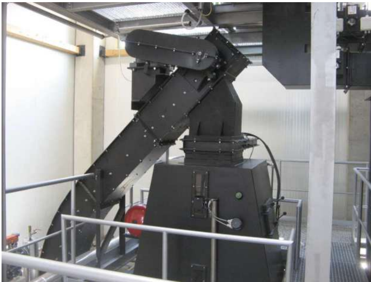
Слика бр. 19: Дозирни систем котла
